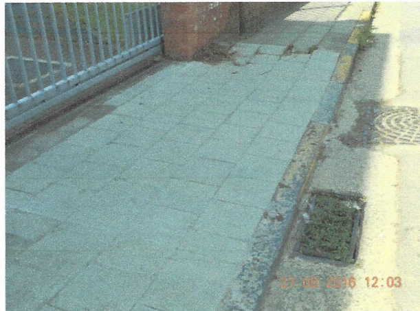
Avaloir bouché - Av. Scandiano (école)
