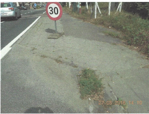
Ch. de Mons - avaloir bouché – Chemin de fer
