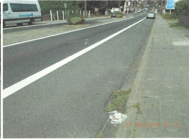
Ch. de Mons - avaloir bouché – chemin de fer
