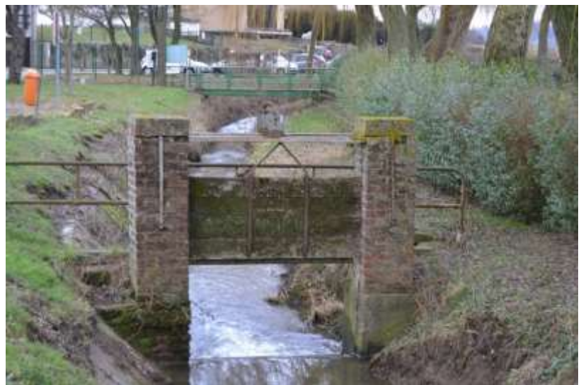
Très ancien ouvrage de retenue réglable situé sur le Coeurcq. Un ouvrage peu coûteux de ce type, permettrait de bloquer et de dévier totalement l'eau du Hain dans la ZIT du «PARADIS»
