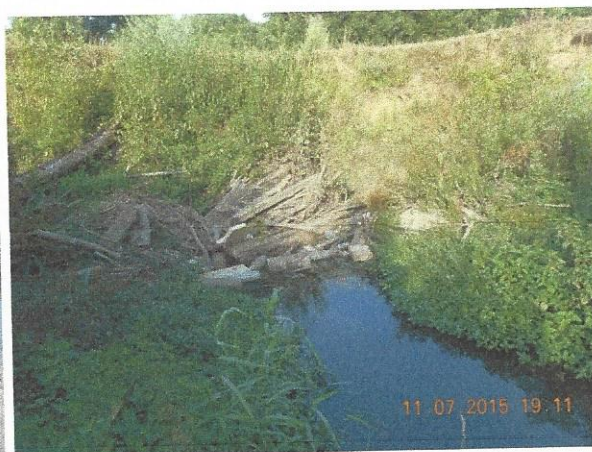
Tuyau de fuite complètement obstrué
