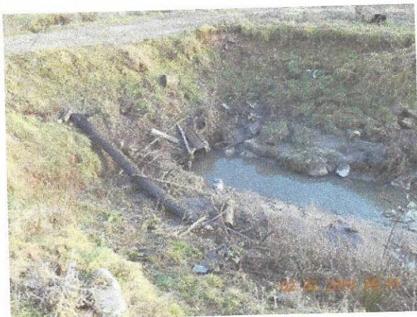
Avant travaux - tuyau de fuite de 60 cm
