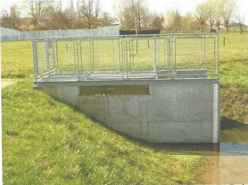
Ouvrage permettant de réguler le niveau d'une des Z.I.T. de Silly
